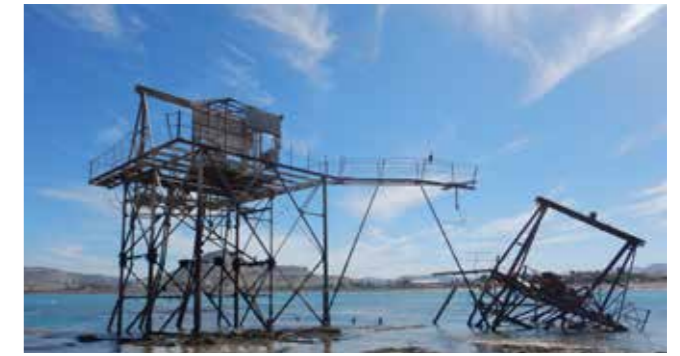
Partes de las viejas pasarelas que unían los pozos en exploración offshore km 5. Foto: gentileza becaria
